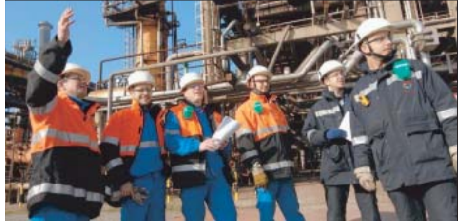
Le Chantier Ecole à Taille Réelle sur le site de l'ex- raffinerie des Flandres, à Mardyck.
